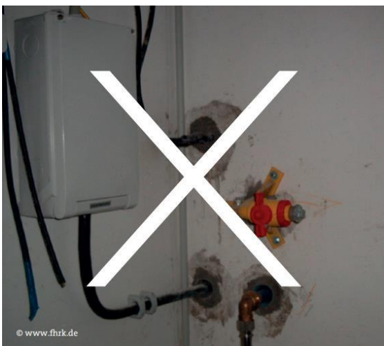
Abbildung 3: Nicht gas- und wasserdichte Ausführung
