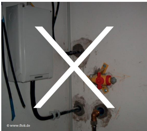
Abbildung 3: Nicht gas- und wasserdichte Ausführung
